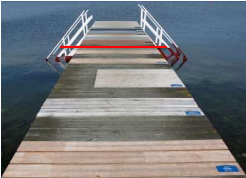
Figur 5. Brygga J, 2014-06-10, kompletterad med flera trämaterial som installerades 2014-03-14 (under det röda strecket).
