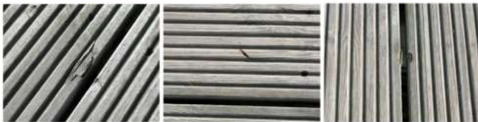
Figur 12. Förekomst av brott i Thermowood® orsakat av materialets sprödhet.
